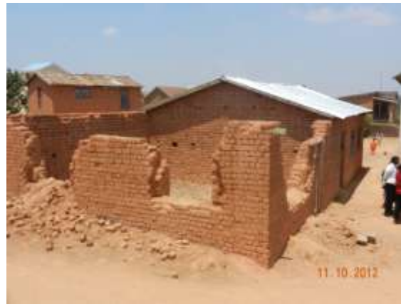
Endommagement des bâtiments annexes
